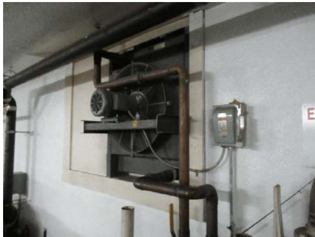
Wall exhaust fan
